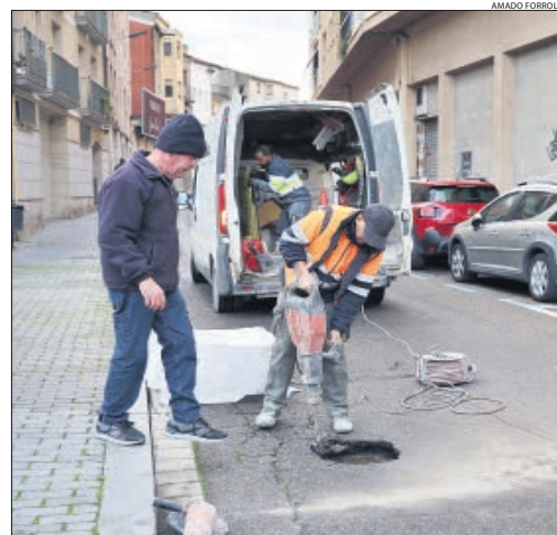
Técnicos levantaron el firme para conocer el alcance del socavón.
