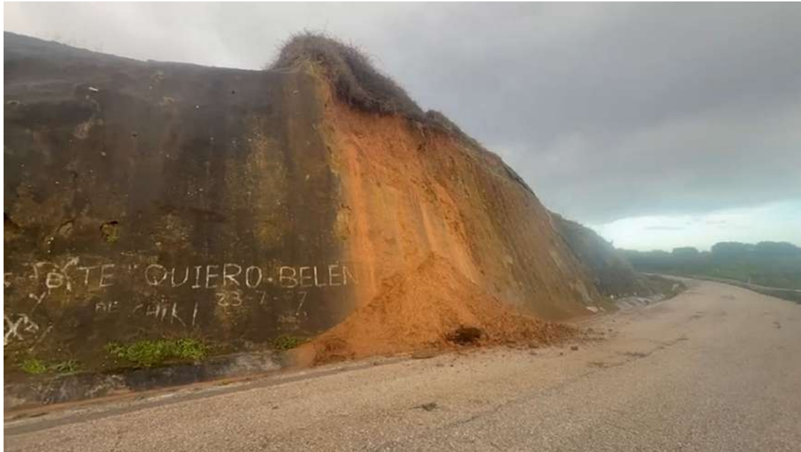
Talud caído en Algeciras.
