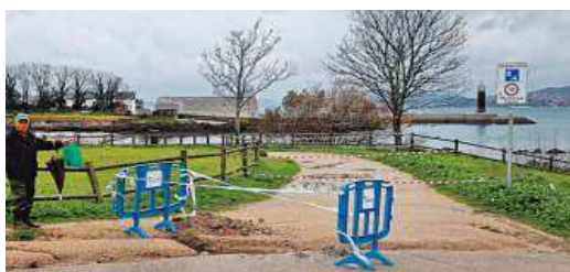
El camino ha sido cortado al tránsito por los desprendimientos.
